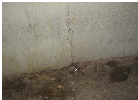
Figura 7.31 – Fissuras causadas pelos deslocamentos diferenciais no corredor de acesso à escada rolante
