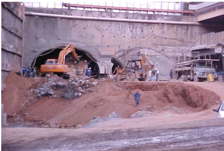
Figura 3.22 - Execução do 1º avanço de 1,0 m na via 1, com demolição do túnel piloto junto à via 1 a cada avanço.
