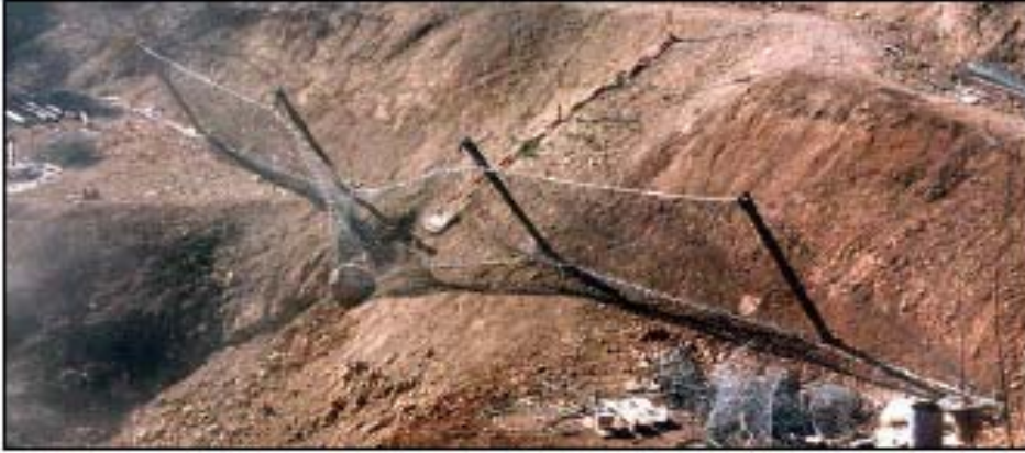
Figura 2.8 – Rede de proteção contra queda de blocos rochosos (Peila & Oggeri, 2005).
