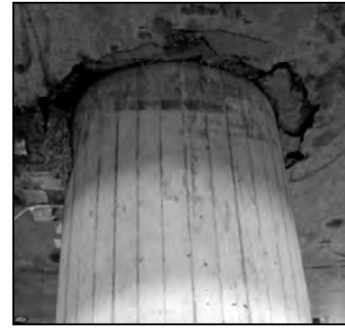
Vista inferior da laje após a ruptura
