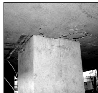
Vista inferior da laje após a ruptura
