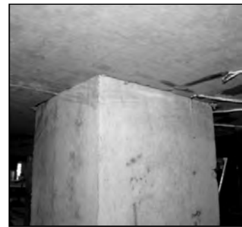
Vista inferior da laje após a ruptura
