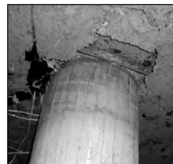
Vista inferior da laje após a ruptura
