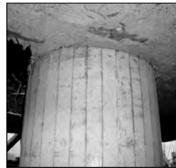
Vista inferior da laje após a ruptura
