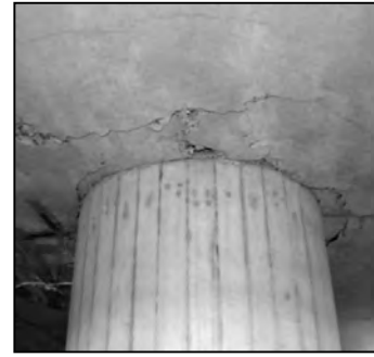
Vista inferior da laje após a ruptura
