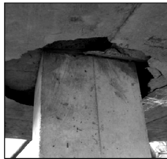
Vista inferior da laje após a ruptura
