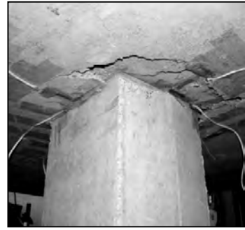
Vista inferior da laje após a ruptura
