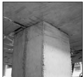
Vista inferior da laje após a ruptura
