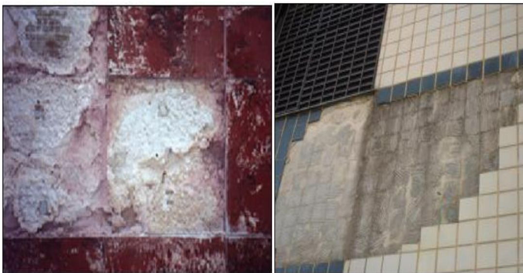
Figura 1.1(a) – Descolamento do porcelanato devido a ruptura do emboço (Cichinelli, 2006); (b) – Descolamento da cerâmica decorrente do rompimento na interface argamassa colante/cerâmica.
