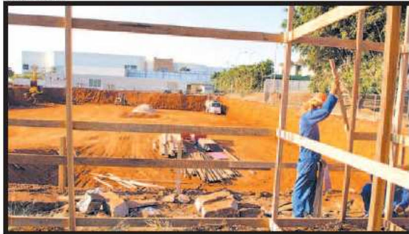
UMA DAS EMPRESAS CAVOU UM BURACO PARA COMEÇAR A FUNDAÇÃO DOS EDIFÍCIOS: NOS ANÚNCIOS PUBLICITÁRIOS, CONDOMÍNIOS COM TODO TIPO DE CONFORTO
