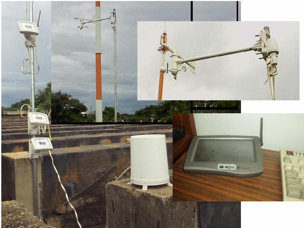
Figura 5.11 -a) Mine estação meteorológica instalada no local.b)unidade principal ligada ao computador
