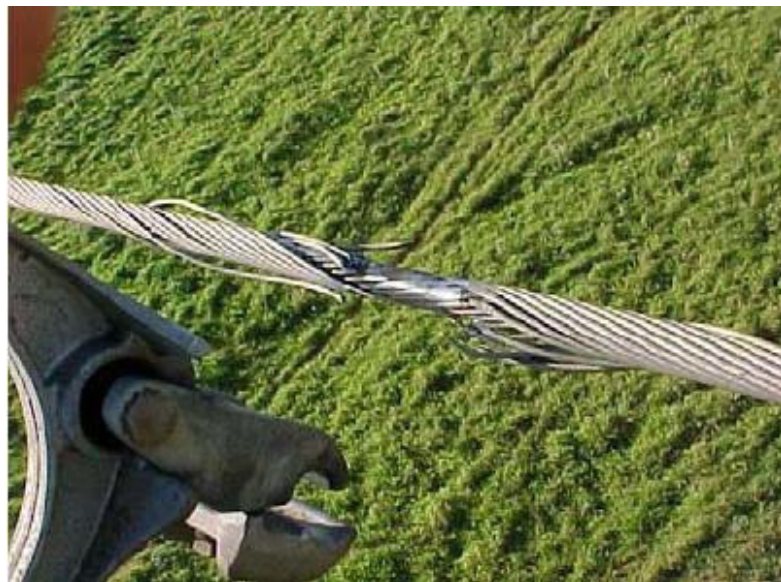
Figura 1.2 – Fios de alumínio rompidos devido à fadiga por fretting [12]
