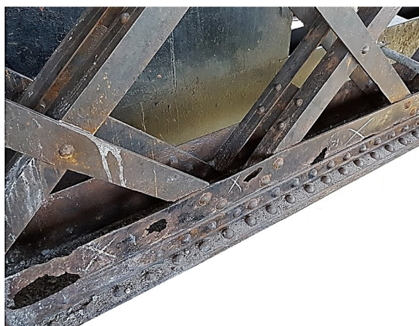
FIGURA 20: FLANGE INFERIOR ENFERRUJADA DA VIGA TRELIÇADA
