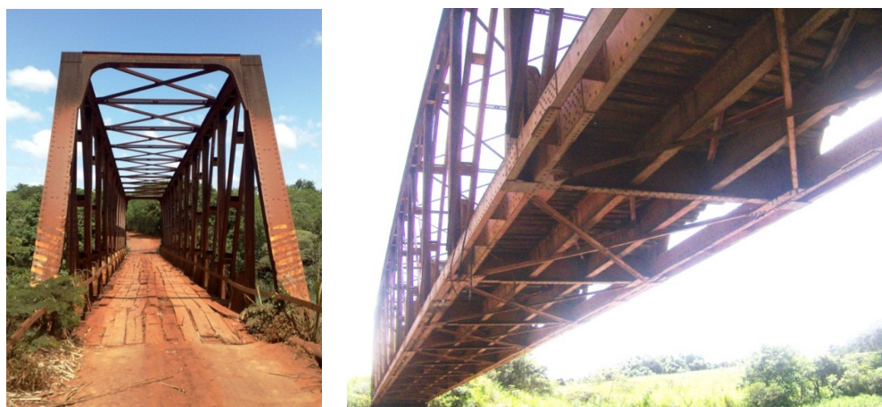
FIGURA 4: ESTADO DA PONTE ANTES DA RECUPERAÇÃO
