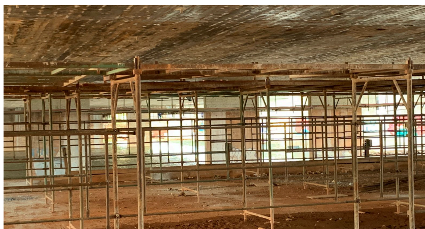
Figura 3: Vista da face inferior do tabuleiro central – danos ocasionados pela humidade
