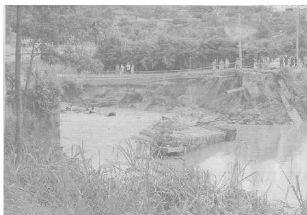
FIGURA 16: VISTA DA PONTE APÓS O COLAPSO
