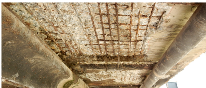
FIGURA 14: SUPERFÍCIE INFERIOR DA LAJE
