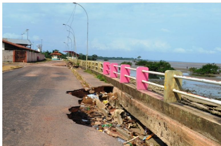
Figura 39 - Erosão na orla do Cidade Nova
