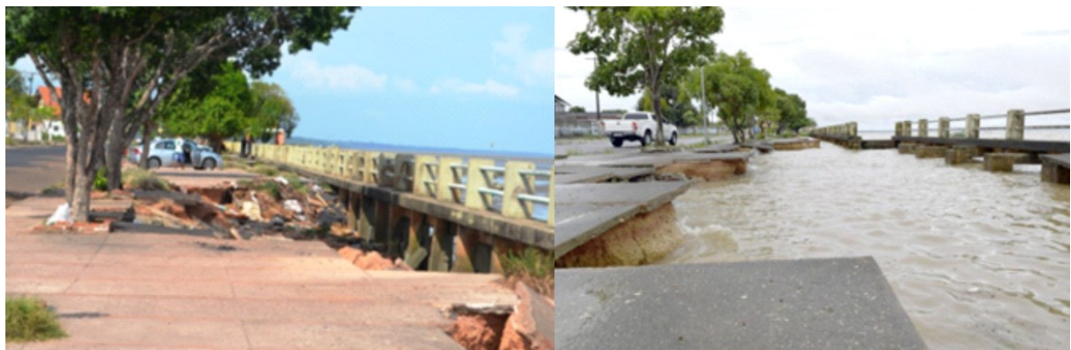
Figura 38 - Erosão no bairro Perpétuo Socorro
