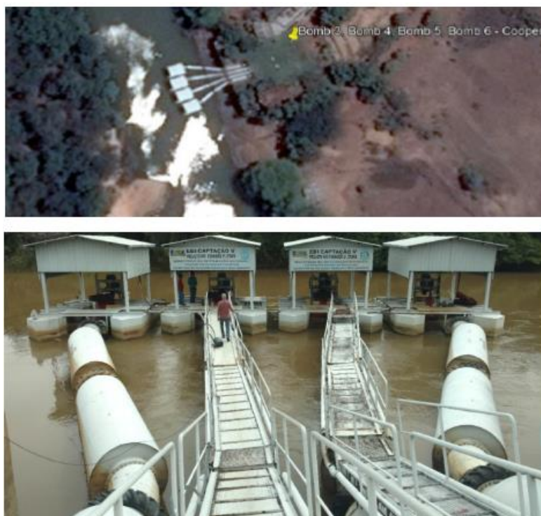
Figura 5 - Bombas de captação na BHRF. Fonte: IAC (2017).
