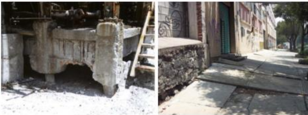
Figura 3.8. Emersão aparente das estacas e outras estruturas (Zaldívar, 2013).
