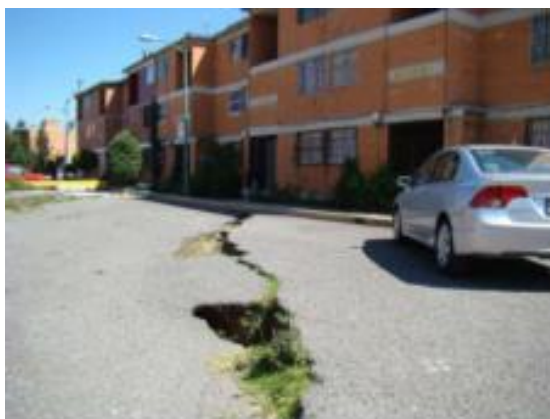
Figura 3.10. Trinca característica numa zona de transição (Santoyo, 2008).
