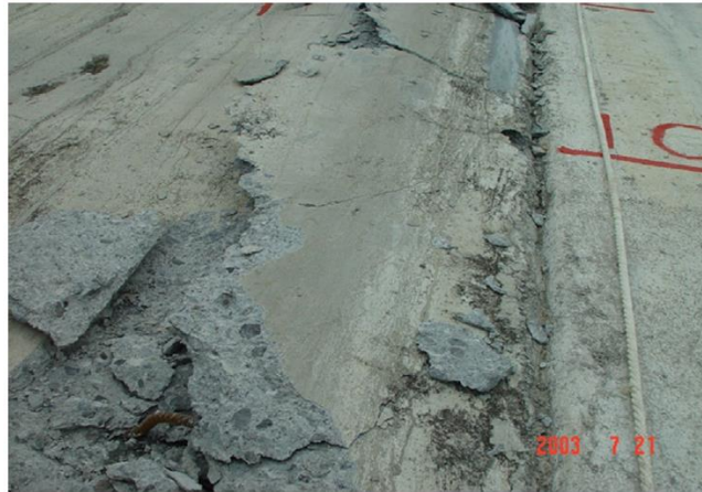
Figura 3.31 – Trincas de extrusão na face da Barragem Tianshengqiao-1 (modificado de Zhou et al. , 2016).
