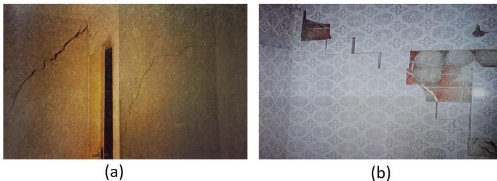
Figura 6 - Fissura por sobrecarga: (a) linear inclinada; (b) formada por fissuras verticais e horizontais (ALCUDIA, 1998)
