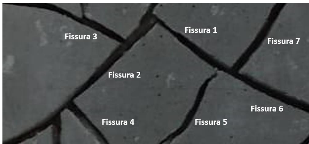
Figura 79 - Identificação das fissuras da placa R5
