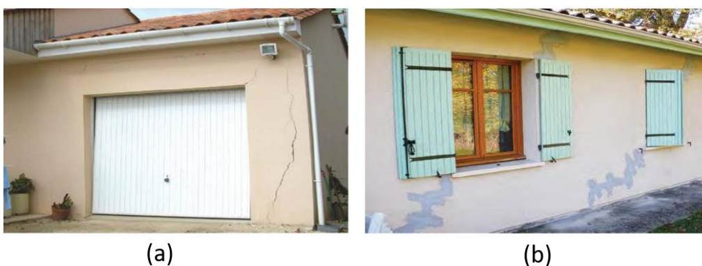
Figura 9 - Fissuras de recalque de fundações: (a) vertical na alvenaria; (b) nos cantos de abertura de janelas (CSTB, 2017, 2021)
