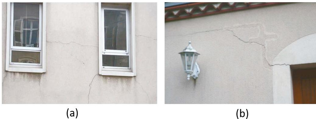
Figura 8 - Fissuras nos cantos de abertura: (a) no canto inferior da abertura de janela; (b) no canto superior da abertura de porta (CSTB, 2017)
