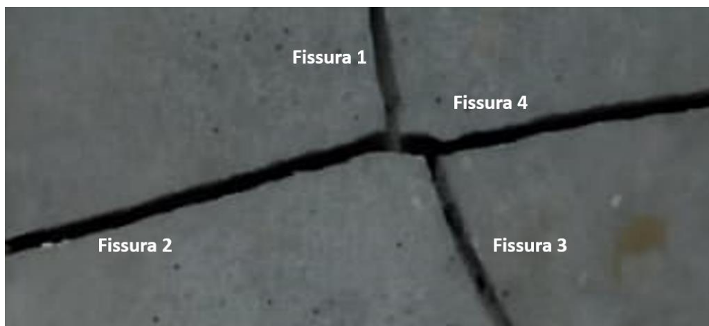
Figura 66 - Identificação das fissuras da placa L5
