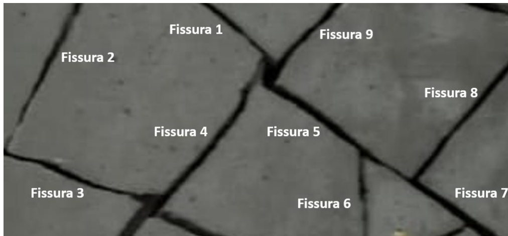
Figura 75 - Identificação das fissuras da placa R3
