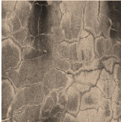
Figura 3 - Fissura ramificada em revestimento de argamassa (CSTB, 2017)
