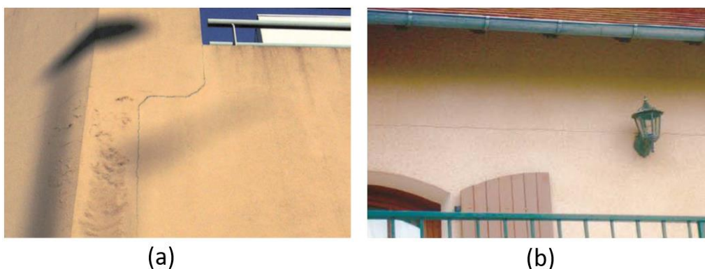
Figura 7 - Fissuras de movimentação de estruturas: (a) na interface pilar/alvenaria; (b) na interface viga/alvenaria (CSTB, 2017)
