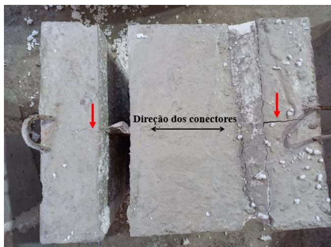
Figura 48 – Fissuras no concreto na mesma direção dos conectores.
