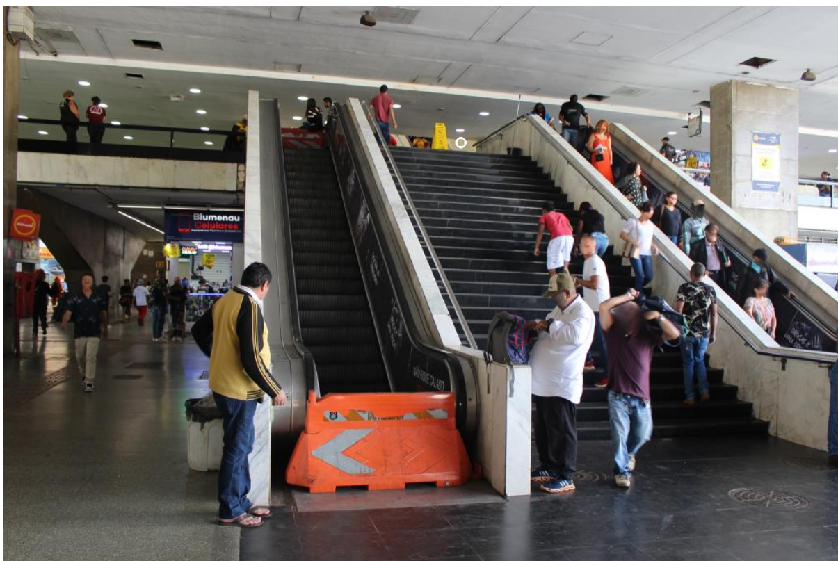
Figura 26: Escada rolante com defeito na Rodoviária do Plano Piloto de Brasília
