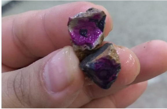
Figura 3.11 - Teste de carbonatação do ARC com solução de fenolftaleína.
