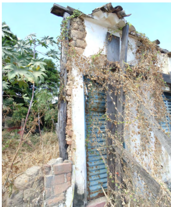
Figura 3: Residência com fachada em ruínas - Cidade de Goiás.
