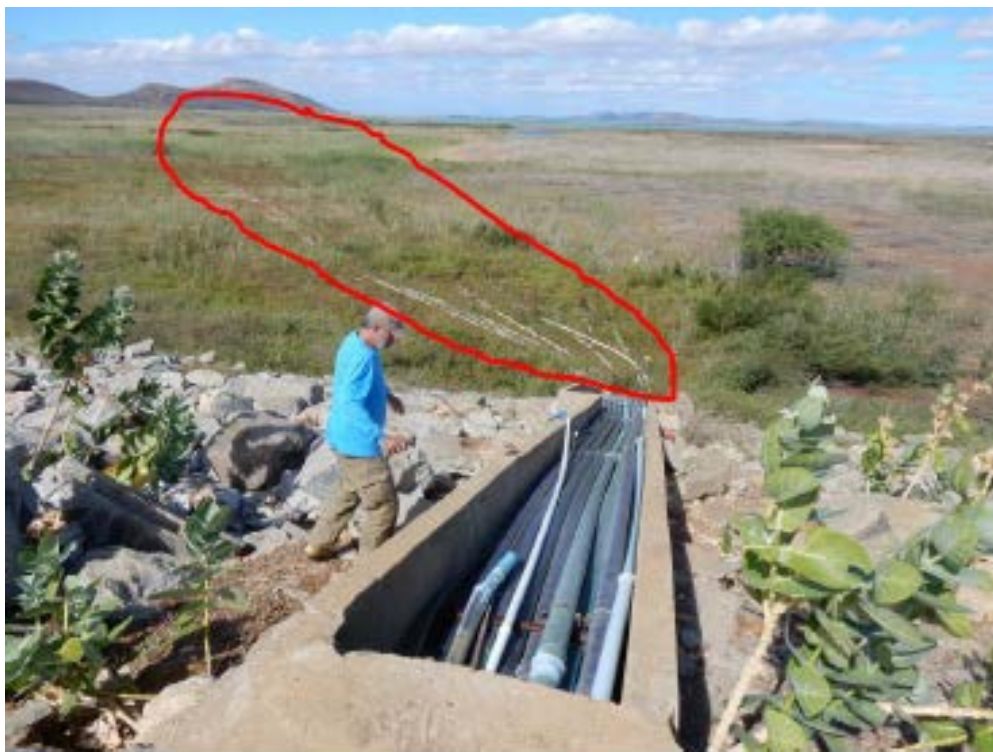
Figura 22 - Vistoria à captação da Associação Comunitária dos Produtores Rurais do Riacho dos Algodões com detalhe das tubulações para alcance do espelho d'água no destaque em vermelho
