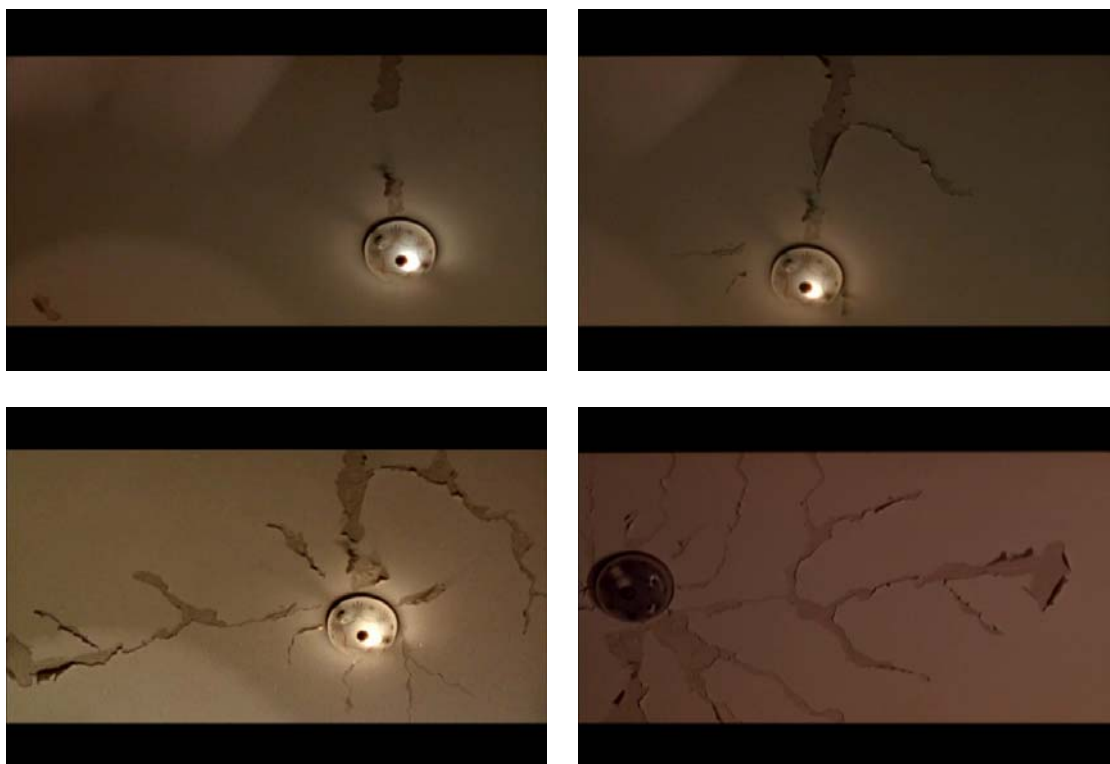
Fig. 6 - Os quatro momentos da rachadura na parede do quarto de ‘Thiago’
