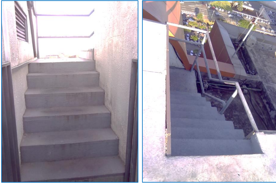
Figuras 88 e 89 – Escada em alvenaria para acesso à plataforma do heliponto fora da norma de acessibilidade
