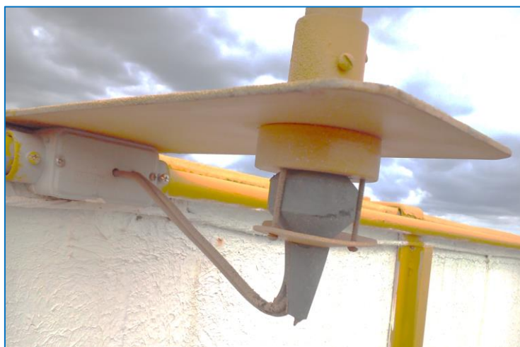
Figura 50 – Situação do cabeamento e bulbo emborrachados de luminária SN05
