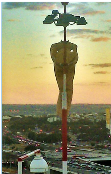
Figura 51 – Cone de vento danificado devido à exposição ao tempo além do previsto pela garantia do fabricante
