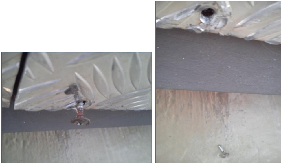
Figuras 54 e 55 – Rebite de fixação das folhas de aço à longarina da rampa de acesso ao heliponto com perda total de função
