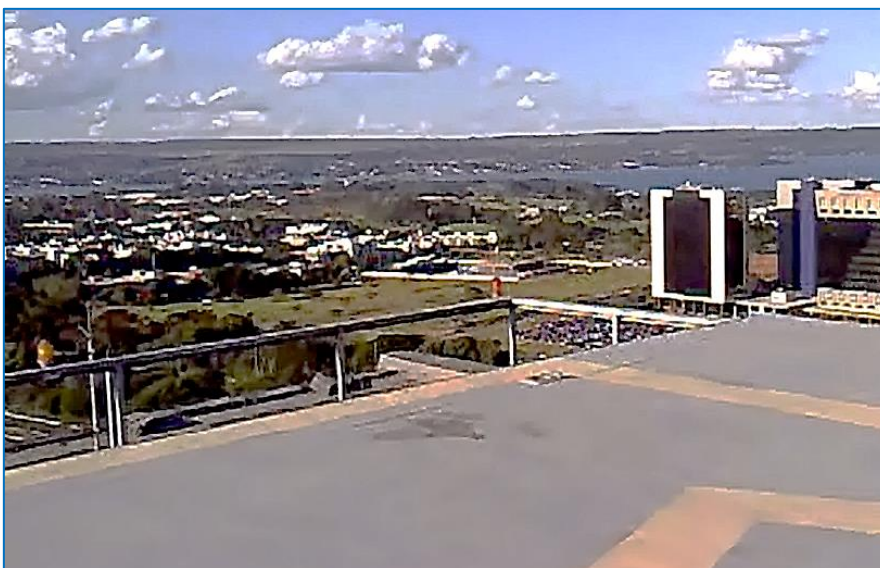
Figura 78 – Manchas na pintura da TLOF ocasionadas por empoçamento de água
