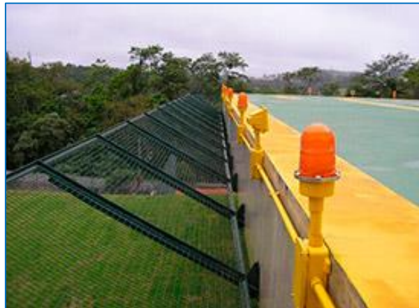
Figura 14 – Sistema de iluminação da FATO composto por luminárias perimetrais da FATO e holofote para iluminação da TLOF. Foto: internet
