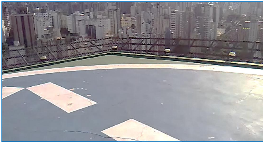
Figura 68 – Sistema de iluminação irregular da FATO
