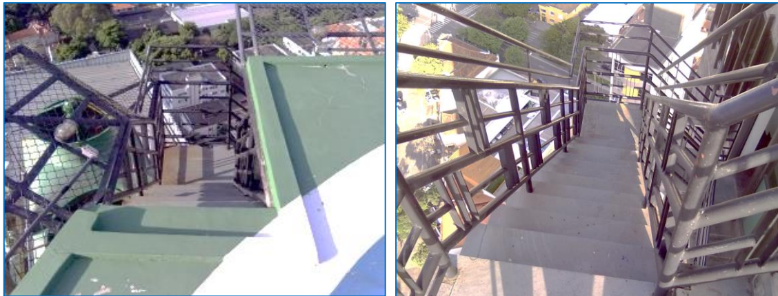
Figuras 69 e 70 – A escada apresenta um alto nível de periculosidade aos usuários
