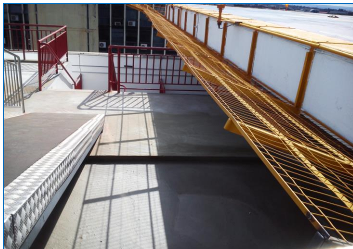
Figura 42 – Grade de segurança de heliponto elevado - lado sul do heliponto inspecionado
