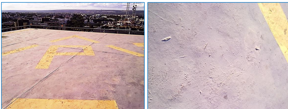
Figuras 79 e 80 – Manutenção ruim de mossas oriundas da operação de aeronaves
