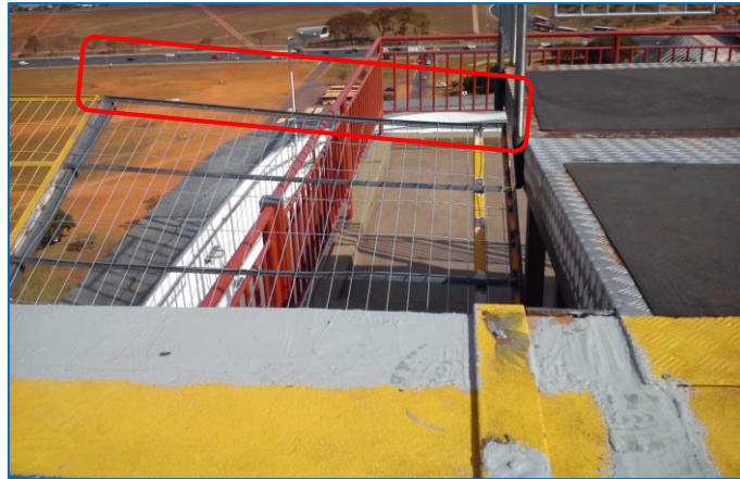
Figura 43 – Longarina e reforço deformados após o 1º teste de carga
