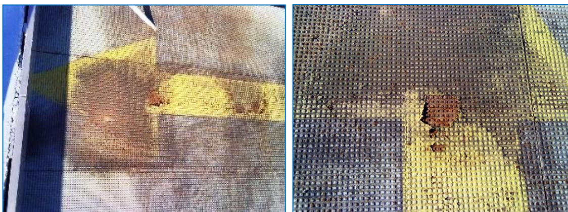
Figuras 81 e 82 – Estado precário de manutenção da FATO, afetando a pintura de uma das setas de orientação de alinhamento
