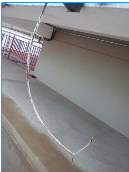
Figuras 46 – Um dos locais onde a cordoalha de cobre da gaiola de Faraday foi cortada por ocasião do deslocamento da rampa de acesso ao heliponto
