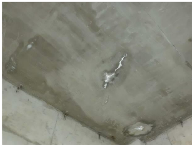
Figura 30 – Área afetada por eflorescência na parte inferior de plataforma de concreto armado. Fonte: internet
