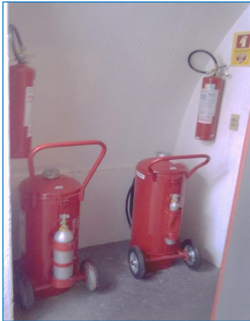
Figura 94 – Extintores em número inferior ao exigido pela legislação, armazenados no andar de serviço embaixo da escada de acesso à PDC
