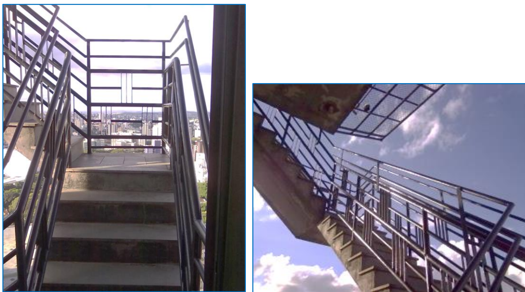
Figuras 71 e 72 – Guarda-corpo e corrimão da escada que liga o último andar tipo da edificação à PDC
