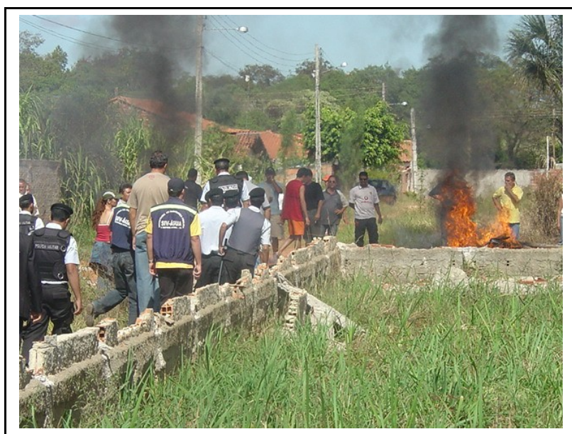
Foto 11: Operação de Erradicação de edificações em Área de Preservação Permanente de Vereda, na Chácara 26 da Micro-bacia do Córrego Samambaia. Fonte: SUDESA/GDF/Dezembro/2005
