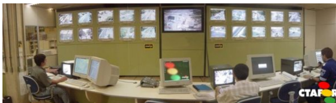
Figura 51. Painel de controle do CTA-FOR. Fonte: CTA-FOR 309 (2007).
