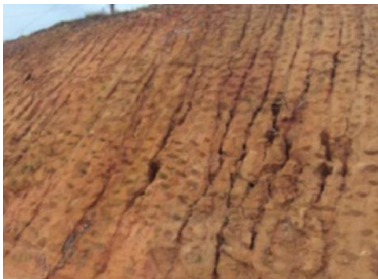
Figura 2.2 - Formação de sulcos erosivos em talude de corte. Fonte: JORNAL SISDERESP (2016)
