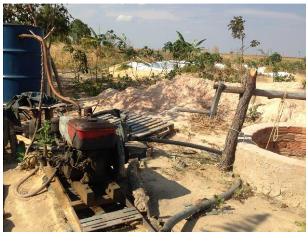
Figura 35 - Sistema de captação vinculado à cisterna. Fonte: Acervo pessoal.
