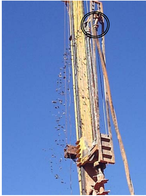
Figura 4.10 – Rompimento da curva metálica durante etapa de concretagem
