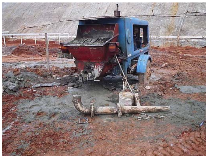
Figura 4.9 – Bomba de concreto apresentando defeito durante etapa de concretagem
