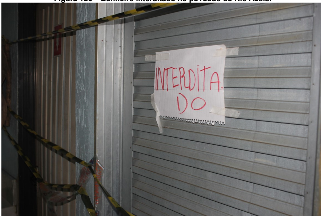
Figura 126 – Banheiro interditado no povoado do Rio Azuis.
