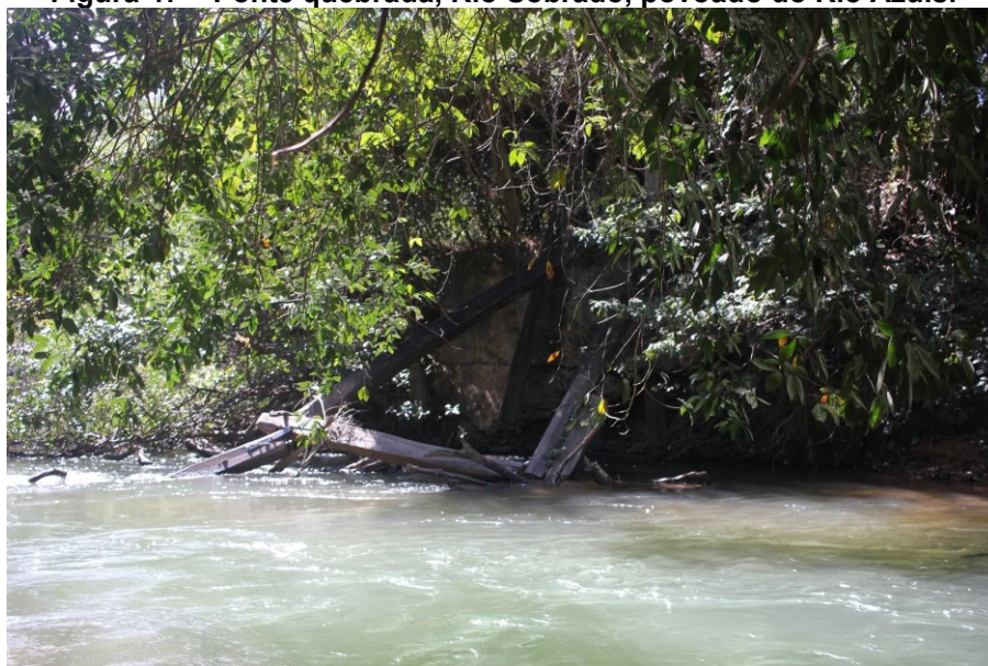
Figura 47 – Ponte quebrada, Rio Sobrado, povoado do Rio Azuis.
