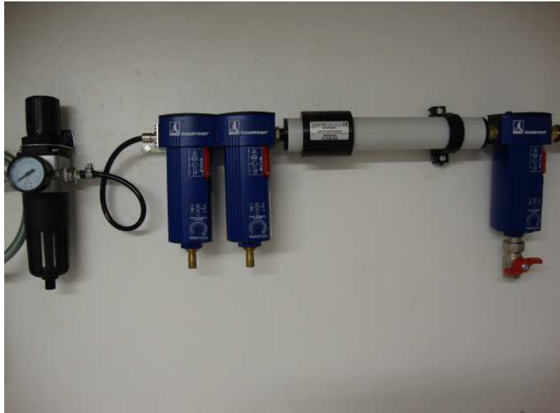
Figura 3.3: Sistemas de filtros de óleo (os dois filtros da esquerda), desumidificador (braço branco horizontal central) e filtro de partículas (filtro mais a direita).
