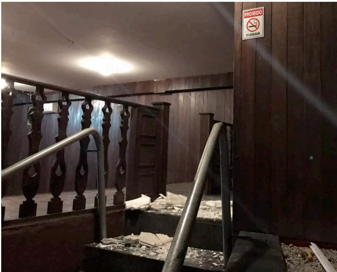
Figura 10: Teto que desabou na escada que dá acesso à Sala Conchita de Moraes no Teatro Dulcina.
