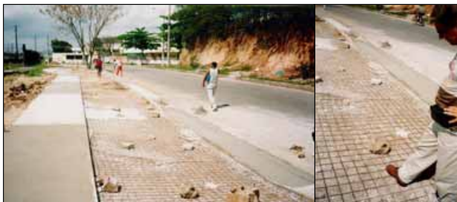
Figura 3.5 – Reforço da base do pavimento em área de cruzamento de veículos sobre a ciclovia em construção em Campo Grande/Rio de Janeiro (GEIPOT, 2001)
