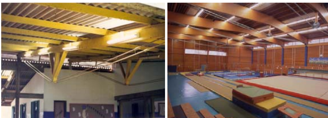
Figura 75 – Vigas tensionadas em escola de Rondônia (de mineradora francesa) e em ginásio na França. Fontes: MELLO (2001) e BOIS-CONSTRUCTION (2007).
