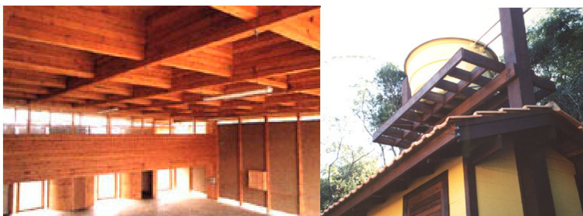
Figura 90 – Grelhas em atelier de carpintaria na França e como apoio de caixa d'água em escritório do IBAMA em Santa Catarina. Fontes: CRIT (2005) e MELLO (1999).
