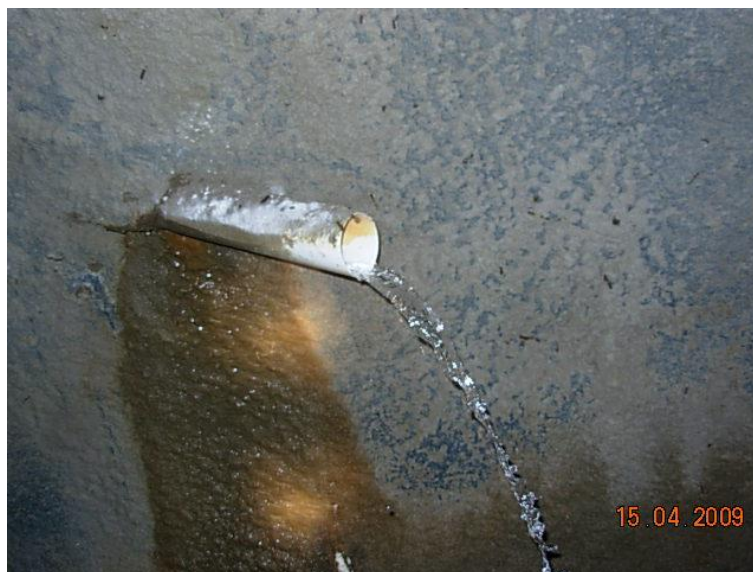
Figura 4.3 - Foto interna do túnel de drenagem mostrando detalhe dos drenos radiais (Figueiredo Ferraz, 2009)
