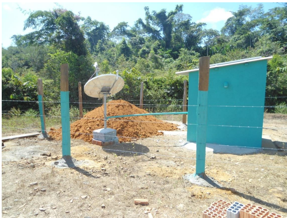
Figura B.6: Visão geral da estação após finalizada a instalação.
