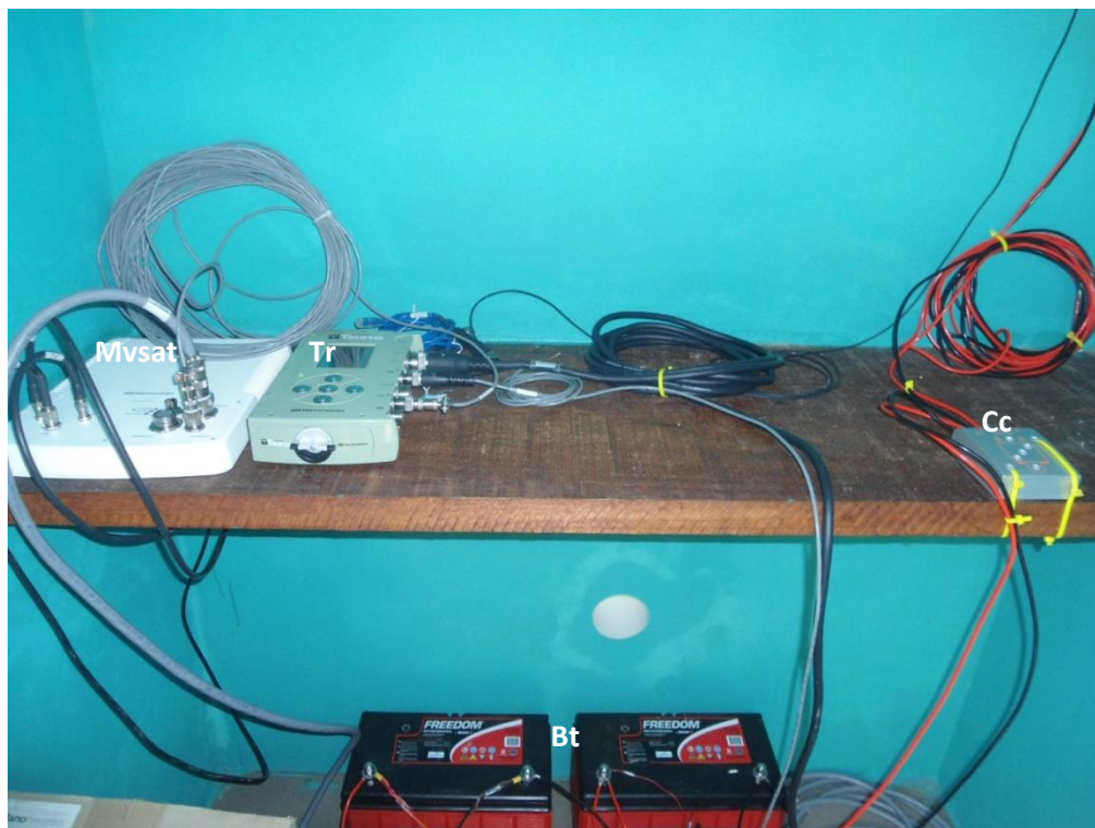
Figura B.7: Visão interna do abrigo de equipamentos. Mvsat= Modem Vsat Cygnus 205. Tr= Digitalizador Taurus. Bt= Baterias. Cc= Controlador de carga.
