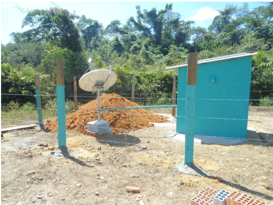
Figura 7: Estação sismográfica de banda larga instalada em Extrema-RO. Estação ETMB pertencente a RSBR.
