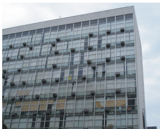
Figura 4-12- Aparelhos de ar-condicionado e improvisos nas fachadas
