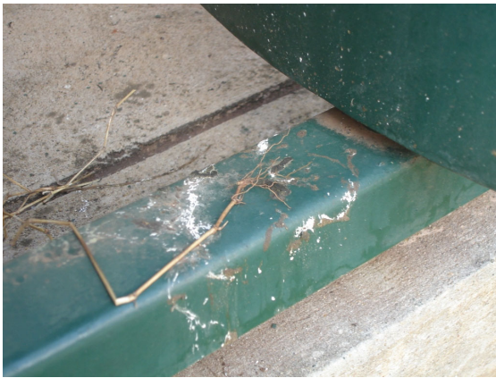
Figura 5-42-Excrementos de pombos na estrutura metálica dos brises
