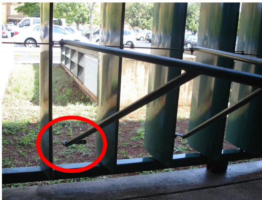
Figura 5-54- Barra de comando danificada
