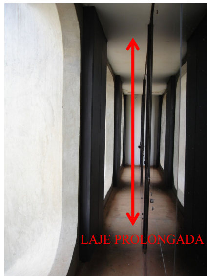
Figura 5-117- Circulação existente entre o brise e a superfície envidraçada: prolongamento da laje
