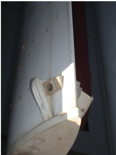
Figura 5-21- Célula fotoelétrica danificada
