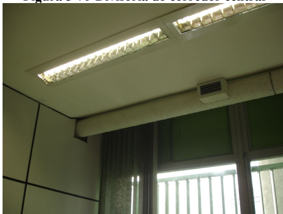
Figura 5-72- Ar-condicionado central, iluminação artificial e persiana cinza
