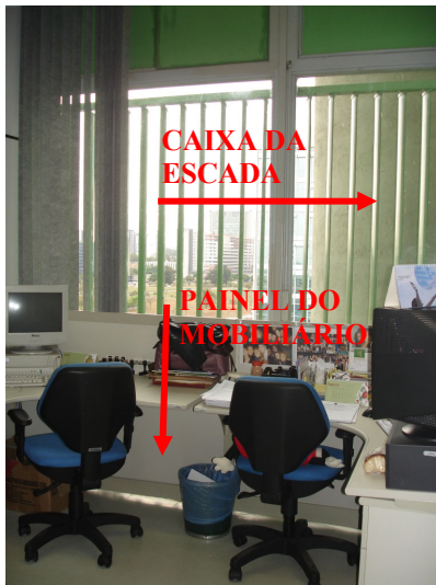
Figura 5-94- Acesso ao brise obstruído pelo mobiliário em frente à janela inferior
