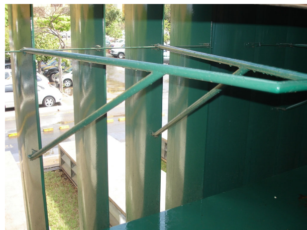
Figura 5-41- Barra de comando dos brises
