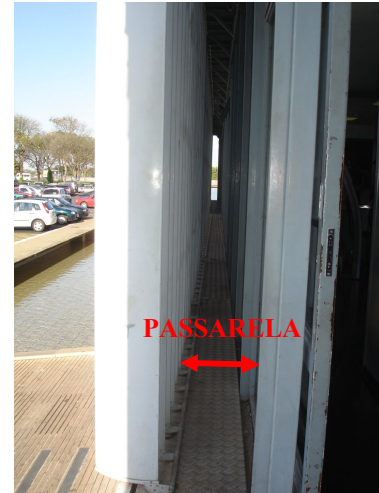
Figura 5-24- Passarela para manutenção
