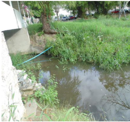
Figura 25: Esgoto acumulado, Campus Sede/UFCG . Fonte: Acervo próprio, 2015.
