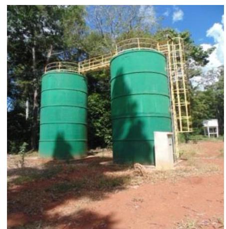
Figura 17: Torres de contenção, Fertirrigação/UFLA. Fonte: Acervo próprio, 2015.
