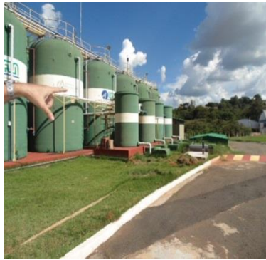
Figura 15: Reatores Anaeróbicos por UASB da ETE, UFLA. Fonte: Acervo próprio, 2015.
