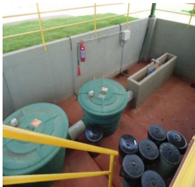
Figura 14: Caixas de Gordura, Estação de Tratamento de Esgoto (ETE), UFLA. Fonte: Acervo próprio, 2015.
