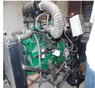
Figura 16: Motor de biodiesel na ETE, UFLA. Fonte: Acervo próprio, 2015.
