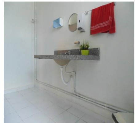
Figura 28: Captação de água servida, Campus Sede/UFCG . Fonte: Acervo próprio, 2015.
