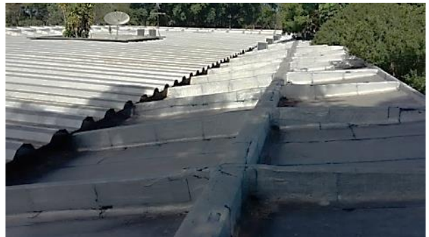
Figura 63 - Cobertura da varanda com as vigas invertidas. Foto da autora (jun/2016)
