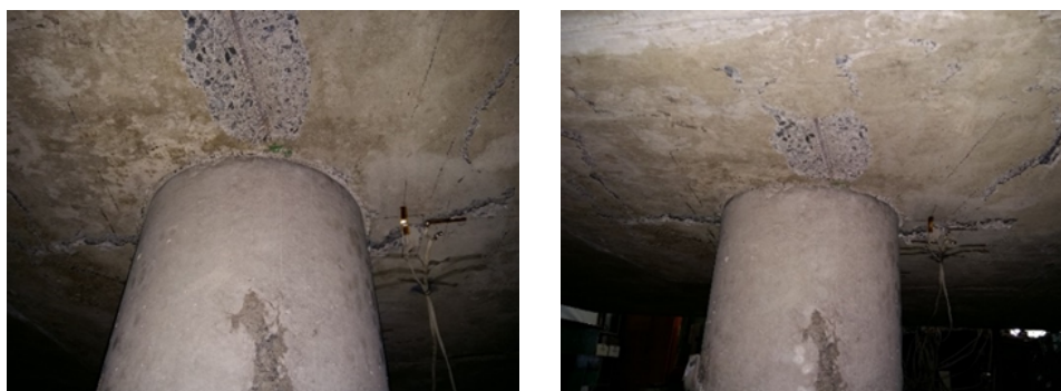
Figura 4.64 – Vista inferior depois da ruptura – Laje BD-A05
