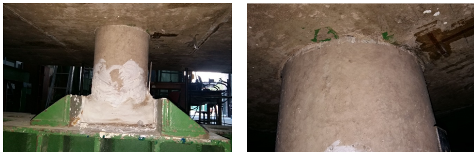
Figura 4.62 – Vista inferior depois da ruptura – Laje BD-A04
