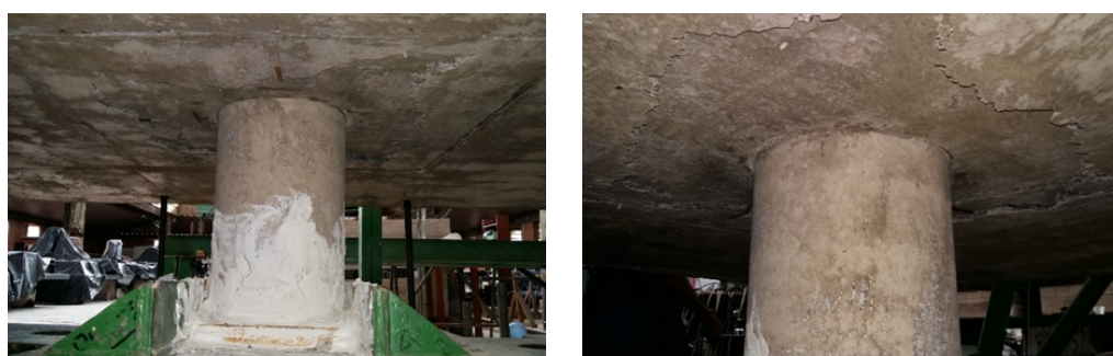
Figura 4.56 – Vista inferior depois da ruptura – Laje BD-A01
