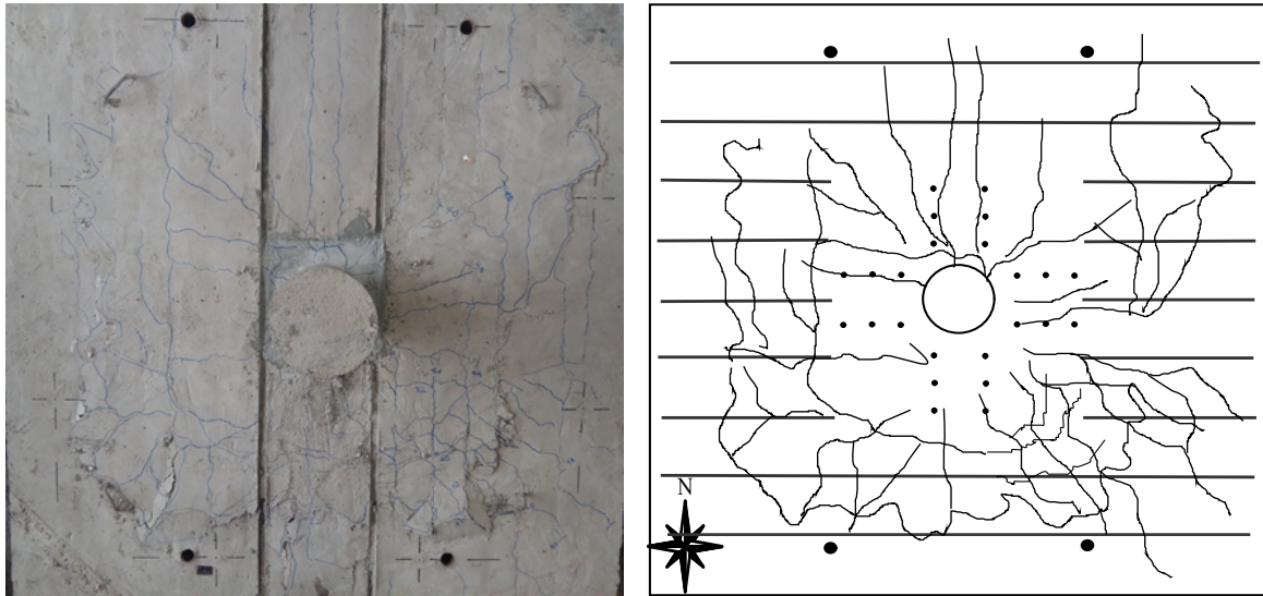
Figura 4.57 – Mapa de fissuração - Laje BD-A02
