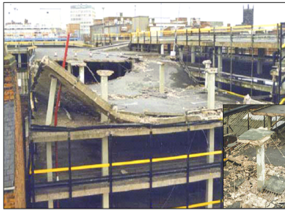
Figura 1.2 – Colapso parcial do edifício Pipers Row Car Park , Lima (2015)
