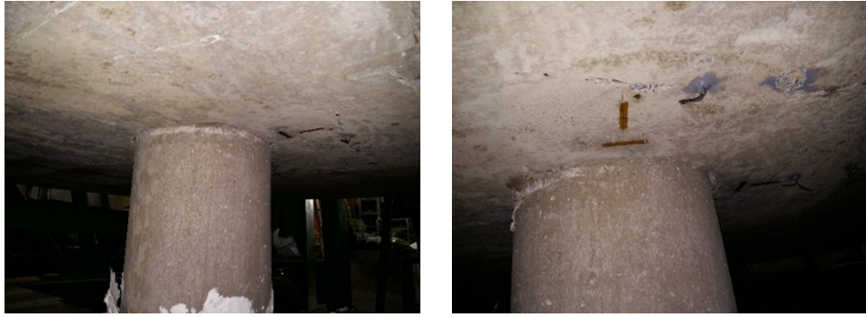
Figura 4.60 – Vista inferior depois da ruptura – Laje BD-A03
