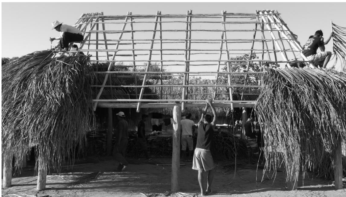
Figura 9: Construção da casa de Pâti. Os homens se dividem na tarefa, os mais jovens carregam a palha, os mais velhos atuam na estrutura de madeira.
