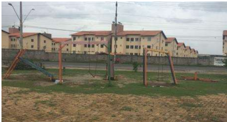
Figura 26 - Playground danificado na praça "Viva Piçarreira"
