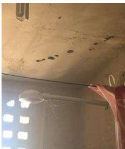
Figura 24 - Sinais de infiltração no forro de um banheiro do Pitangueiras I
