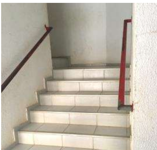
Figura 39 - Escada com corrimão não-contínuo
