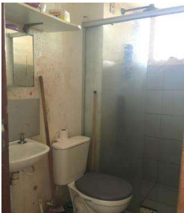
Figura 15 - Banheiro de UH do Pitangueiras sem azulejo na parede hidráulica
