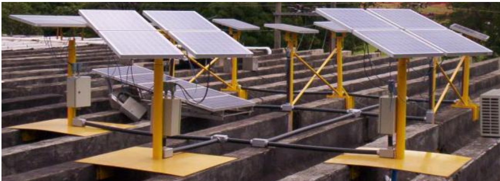
Figura 4.7 – Eletrodutos protegendo os alimentadores da exposição solar
