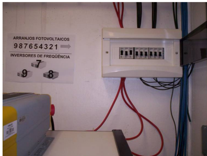
Figura 4.18 – Disjuntores de desconexão, para isolar o controlador de carregamento dos painéis fotovoltaicos
