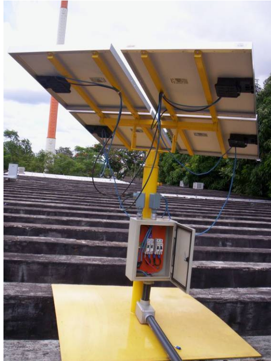
Figura 4.17 – Disjuntores de proteção individual dos painéis dentro de um mesmo arranjo.
