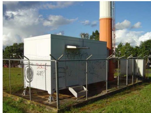
Figura 5: equipamentos localizados em contêineres
