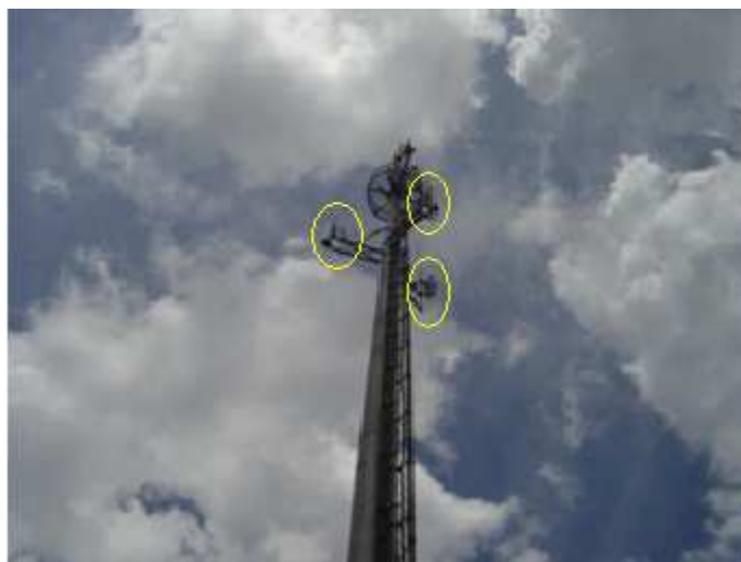
Figura 17: Setorização das antenas na torres
