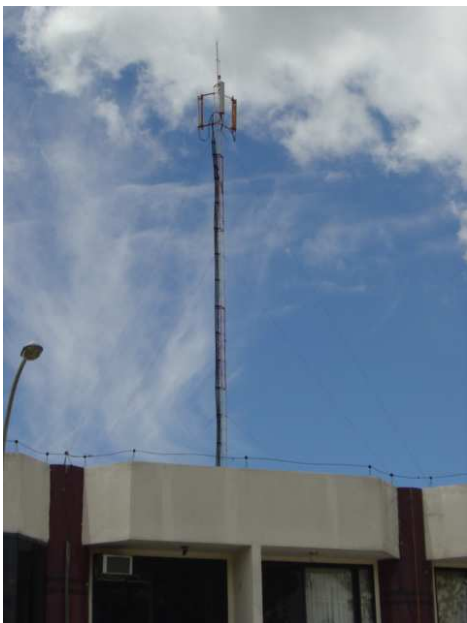
Figura 15: Estação Radiobase tipo Roof top
