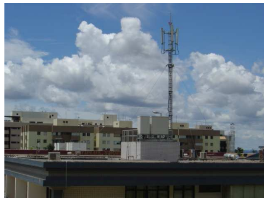
Figura 16: Estação Radiobase tipo Roof top
