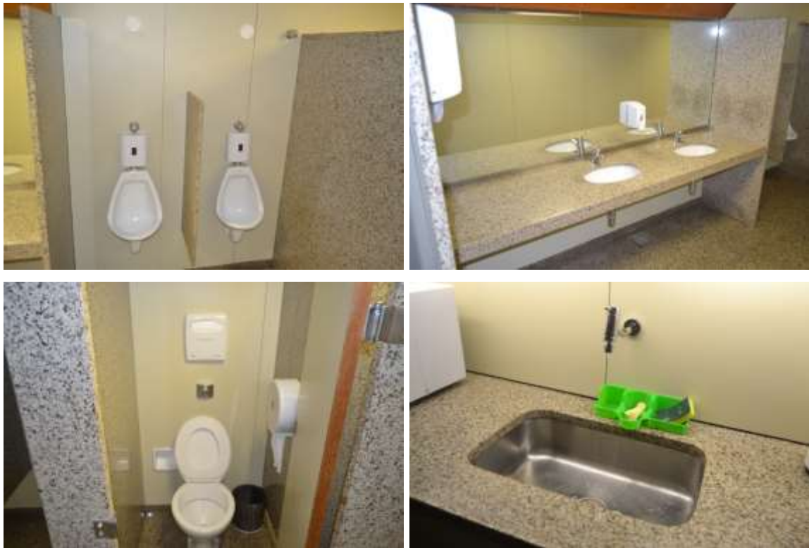
Foto 9 – Peças sanitárias e das copas dos Anexos I, II, III e Restaurante do TCU em Brasília/DF
