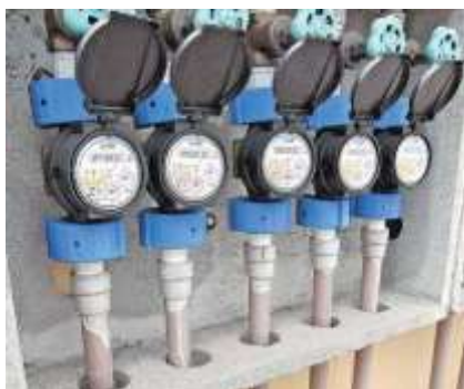
Foto 2 – Exemplo de hidrometração unitária instalada
