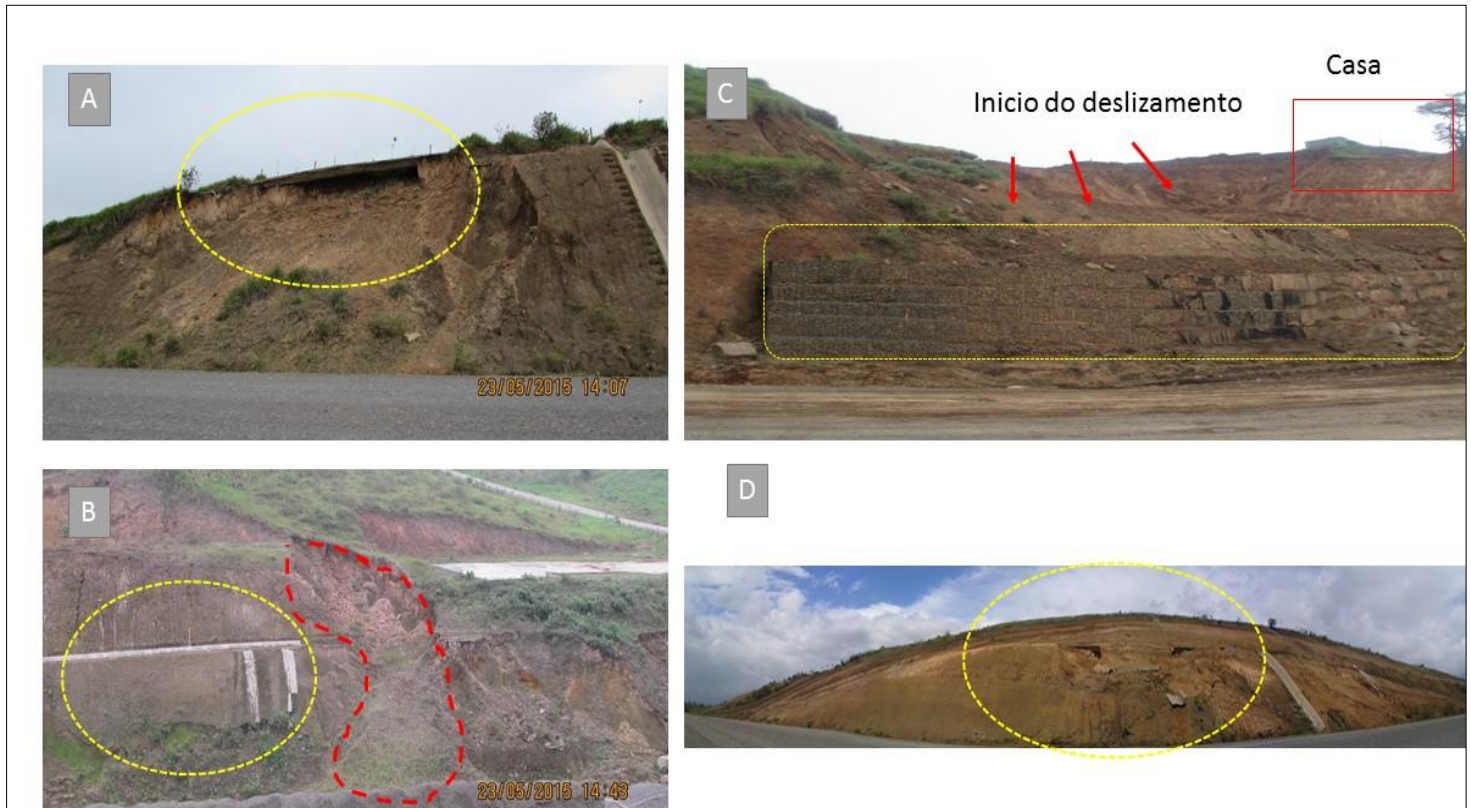
Figura 3.24. Sistemas de tratamento colapsados.
