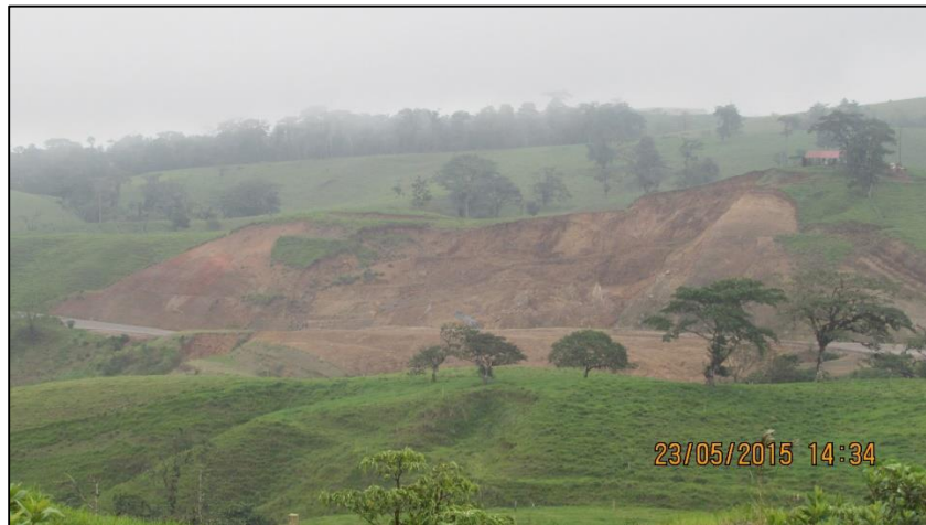
Figura 3.39. Fotografia do Deslizamento estaca 25+550
