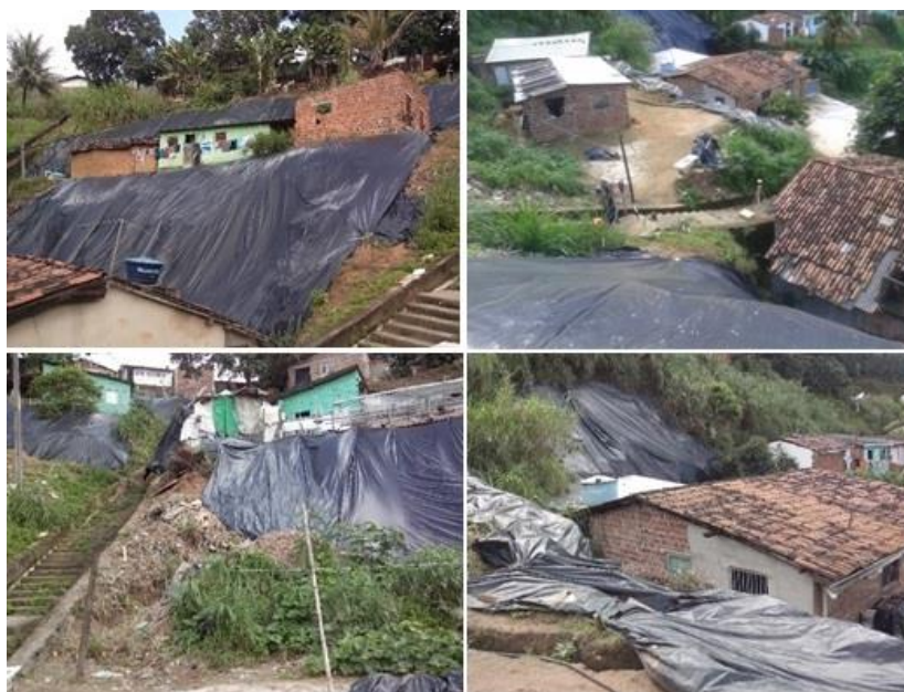
Figura 6.47 Aspecto da área de estudo, objeto do levantamento GNSS e Topográfico, na Subida para o Alto do Reservatório - Córrego do Joaquim - Nova Descoberta, com predominância de encostas cobertas com lonas (Foto: Sergio Melo).
