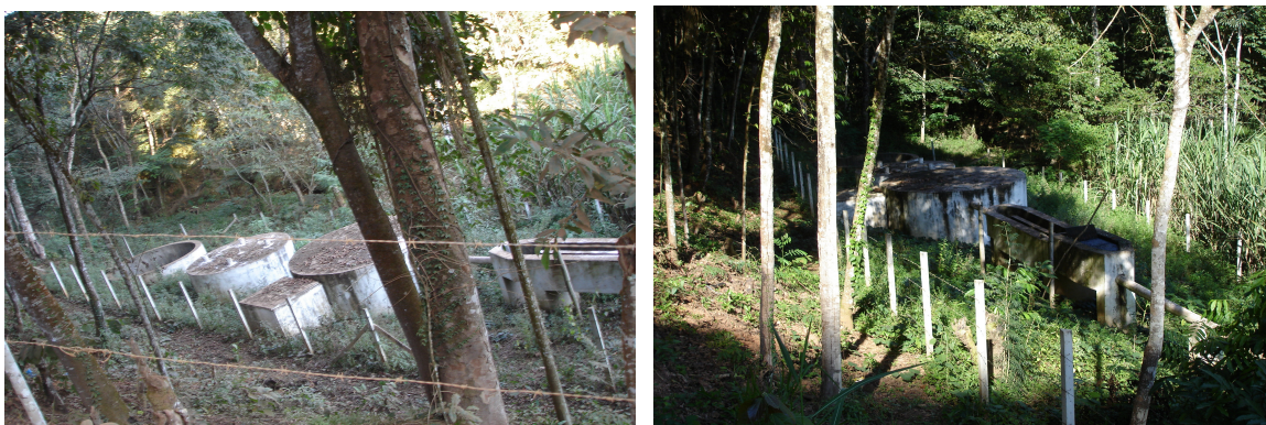
Fig. 4.49 4.50: Estação de tratamento de esgoto (ETE) e seu transbordamento, trazendo desconforto para os visitantes e para os moradores do Povoado de Tabuleiro. (2005)
