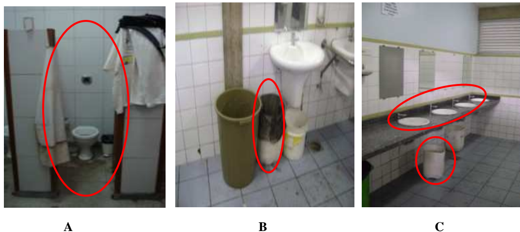
Figura 10 – Inadequações identificadas para o Bloco E - Manipuladores de alimentos, nas instalações sanitárias. A - Ausência de portas; B - Lixeira sem tampa; C - Pias sem sabonete e sem toalhas.
