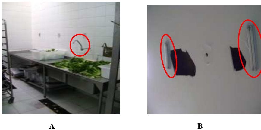
Figura 3 – Inadequações identificadas para o Bloco A - Avaliação das edificações e instalações, na área de produção. A- Área de higienização e pré-preparo de hortaliças sem POP específicos; B- Iluminárias sem proteção contra quedas e explosões.
