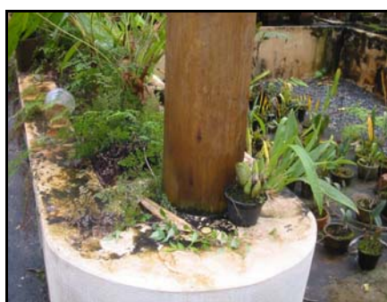
Figura 58 – Pilar recebendo umidade
