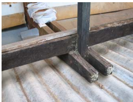
Figura 39 – Apodrecimento da extremidade das vigas (vista externa)
