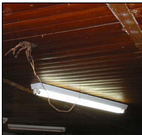
Figura 33 – Eletricidade sem manutenção
