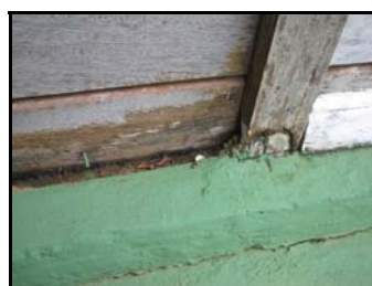
Figura 61 – Madeira da parede deteriorada na base
