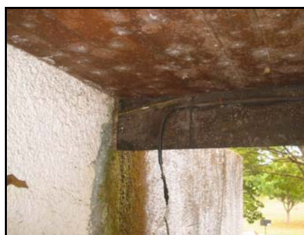
Figura 36 – Apodrecimento da tábuca de beira (vista interna)
