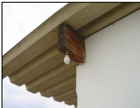
Figura 51 – Ação da chuva em vigas
