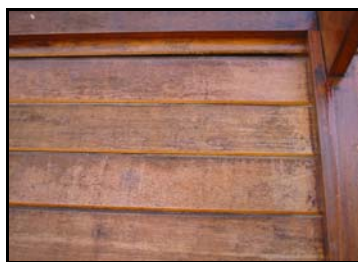
Figura 62 – Retração transversal das peças provocando abertura nas paredes.
