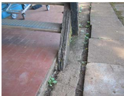
Figura 37 – Gretas e fendas
