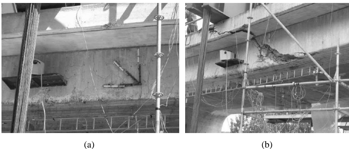
Figura 2.18- Cenários de dano: (a) Pequenas fissuras; (b) Ruptura por cisalhamento (Estrada, 2008).
