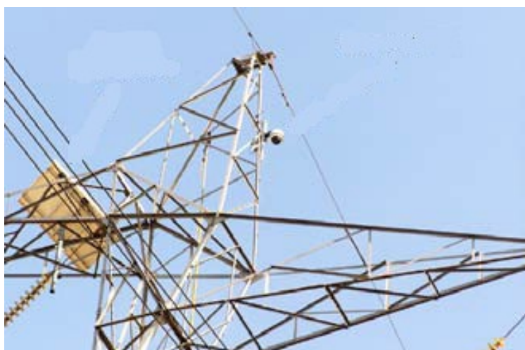
Figura 13: Linhas de Transmissão de Energia Elétrica
