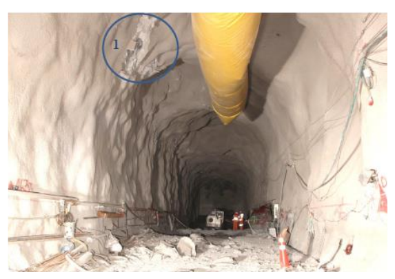
a) Início zona de dano gerada pela instabilidade dinâmica.
