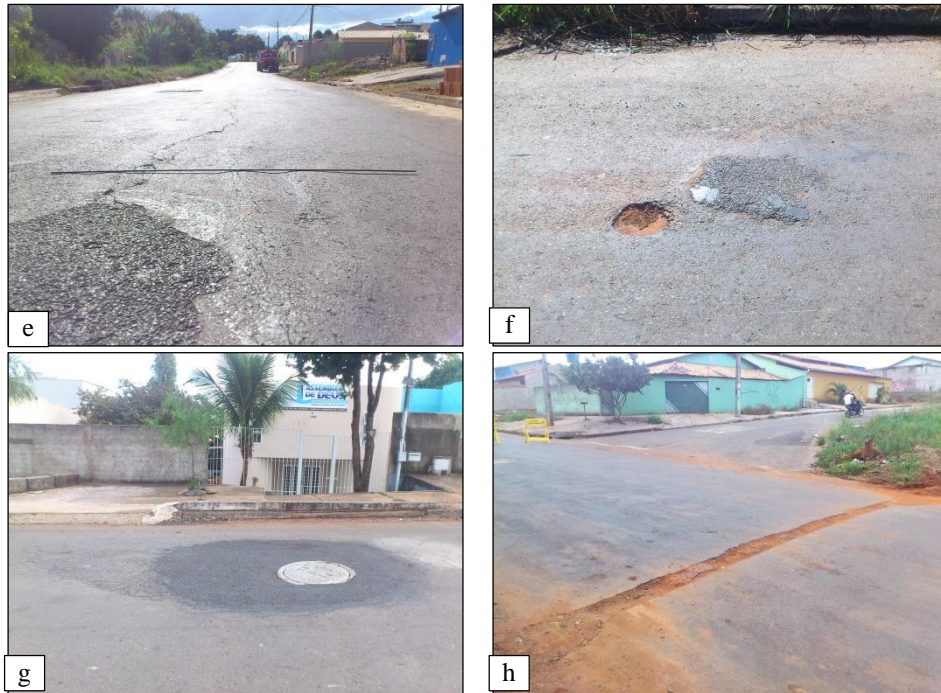
Figura 3.20(continuação). Defeitos superficiais levantados em campo em junho de 2014: (e) Afundamento na trilha de roda interna, trinca longitudinal, remendo; (f) Panela; (g) Instalação da rede de esgoto; (h) Escavação transversal para passagem de canalizações.
