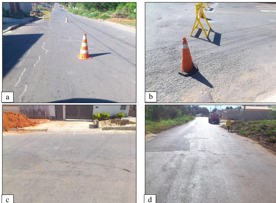
Figura 3.20. Defeitos superficiais levantados em campo em junho de 2014: (a) Trincas longitudinais em trilhas; (b) Trincas tipo couro de jacaré; (c) Trinca longitudinal; (d) Remendos;
