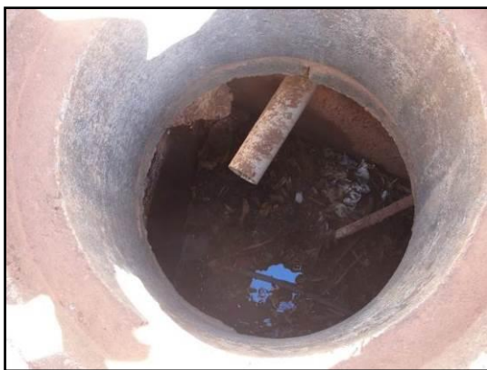
Figura 7: Lançamento de esgoto na rede de águas pluviais no Córrego Grotão.
